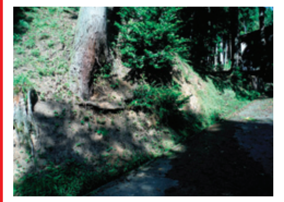
崩壊のおそれ有り
