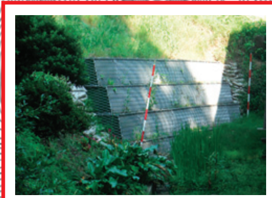
工事をしていない場所が危険
